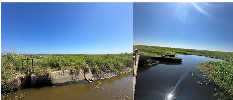
Figura 13. Vista frontal do estado de degradação de canal de drenagem na ZEEA-L
